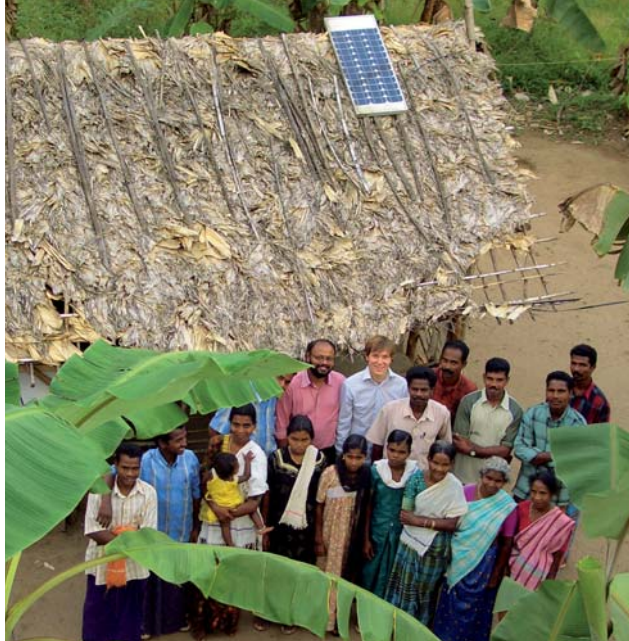
In questo villaggio in una riserva naturale in India l'energia per dieci famiglie viene fornita dai Conergy Solar Home Kit.
